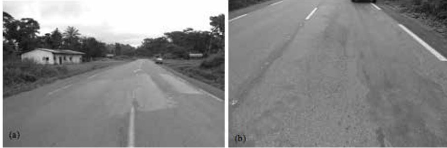
Fig. 2 Mise en évidence des réparations (a : nids-de-poules, b : faiencage) antérieures à cette étude.
