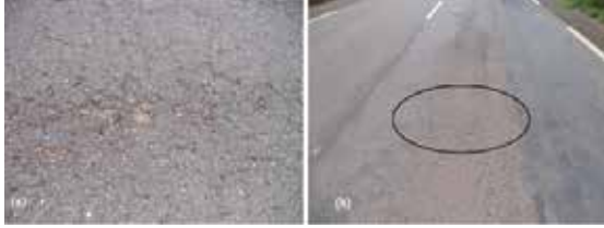
Fig. 5 Vue en plan de la dégradation du tronçon étudié. a : faïençage de dessiccation, b : affaissement de la bande déroulement avec ornière de 2 à 5 cm. Le cercle indique une zone d'affaissement prononcé.
