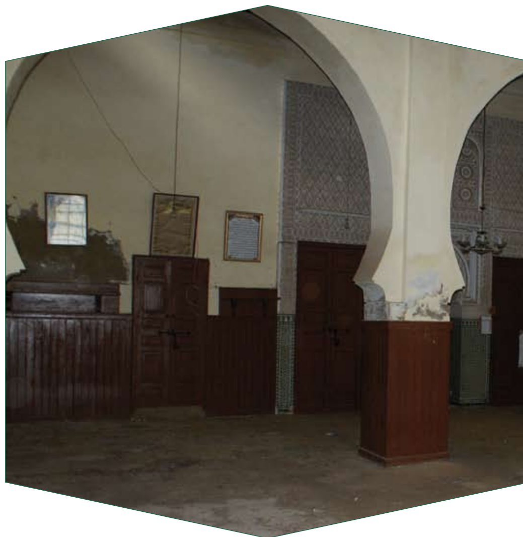
Une vue de parties dégradées d'une mosquée.
